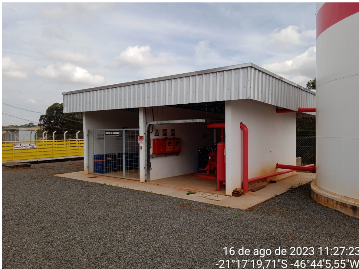
Imagem 4: Casa de bombas de incêndio.
