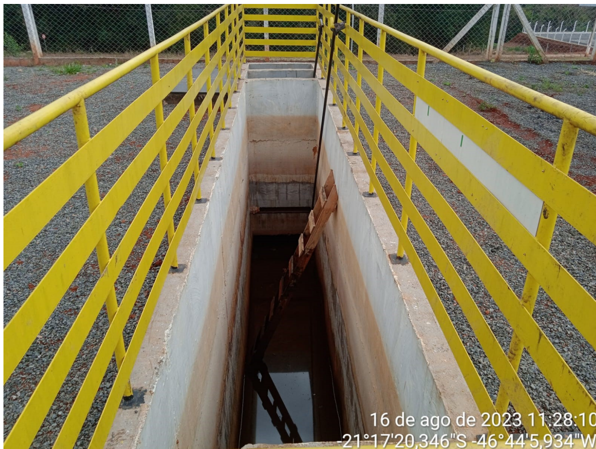
Imagem 6: Separador de água e óleo em concreto armado.
