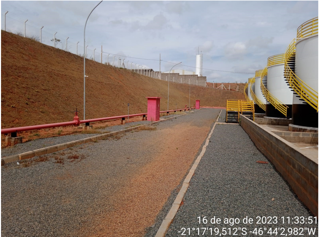
Imagem 9: Diversos abrigos de incêndio em alvenaria e concreto armado.
