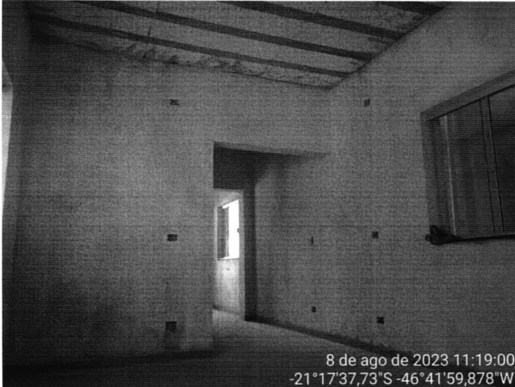
Imagem 17: Pavimento superior do escritório: caixas de tomada sem espelho, paredes sem pintura ou acabamento, laje de forro sem reboco e sem luminárias.
