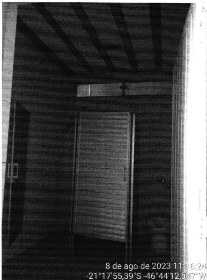
Imagem 11: Laje que cobre o banheiro 1 do escritório sem reboco e sem iluminação.
