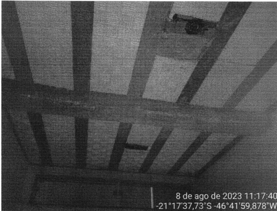
Imagem 15: Laje que cobre o banheiro 2 do escritório sem iluminação, instalação elétrica inacabada.
