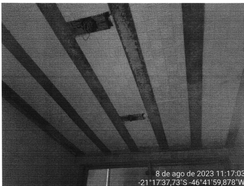
Imagem 12: Laje que cobre o banheiro 1 do escritório sem iluminação, instalação elétrica inacabada.
