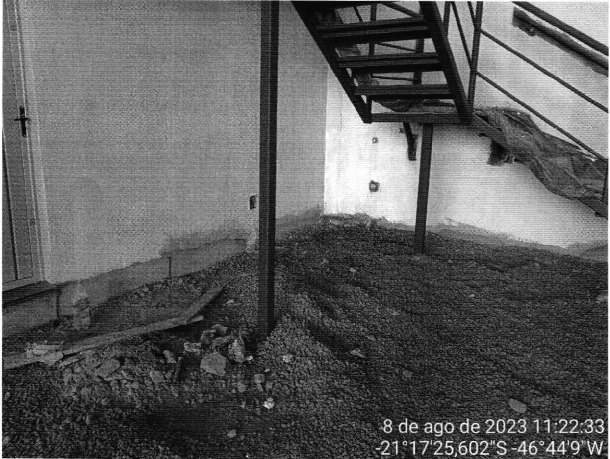
Imagem 23: Limpeza de obra ainda não concluída, paredes sem pintura ou acabamento, caixas de tomada sem espelho.
