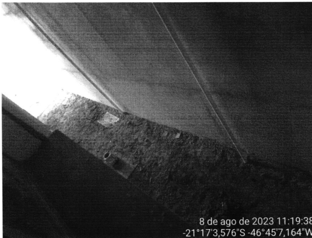
Imagem 18: Piso inacabado no corredor lateral do escritório.
