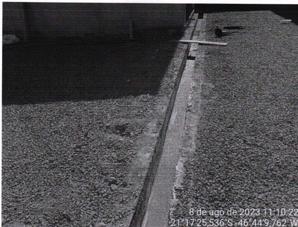
Imagem 7: Canaleta pluvial recentemente concretada, sem grelha.
