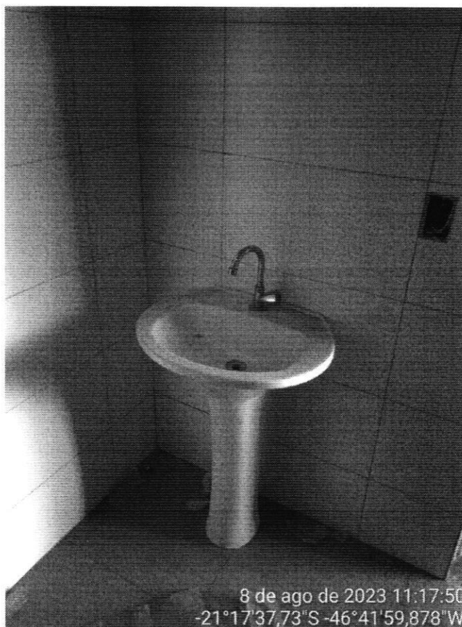
Imagem 14: Lavatório sujo (obra ainda não foi limpa), caixa de tomada sem espelho, sem suporte para papel toalha ou saboneteira. Banheiro 2.
