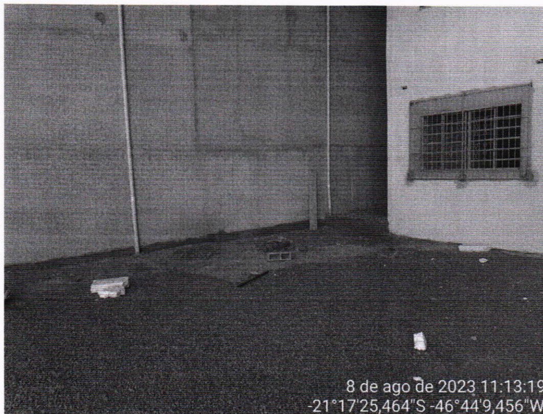
Imagem 8: Obra sem limpeza, proteção de janela chumbada sem pintura ou acabamento.
