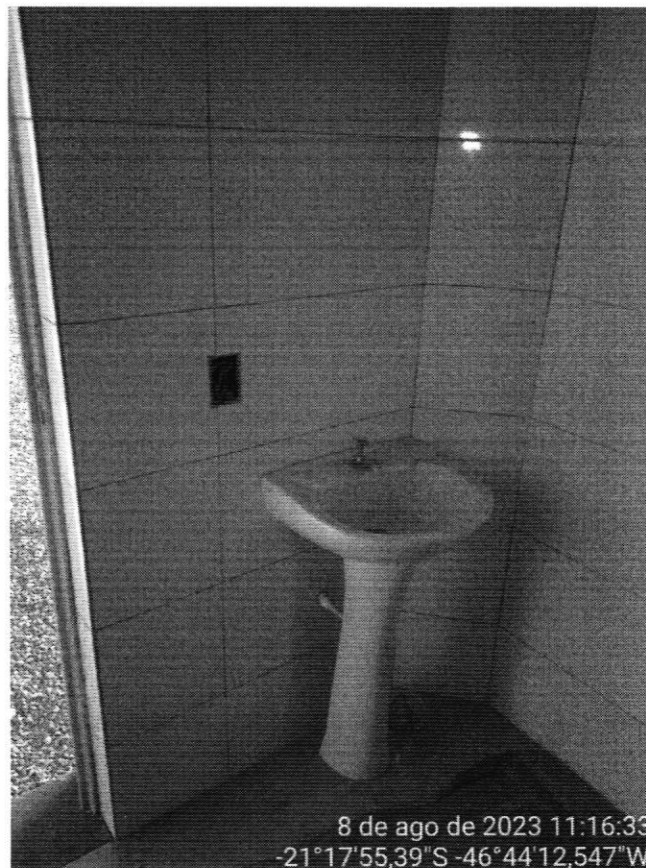
Imagem 10: Lavatório sujo (obra ainda não foi limpa), caixa de tomada sem espelho, sem suporte para papel toalha ou saboneteira. Banheiro 1.
