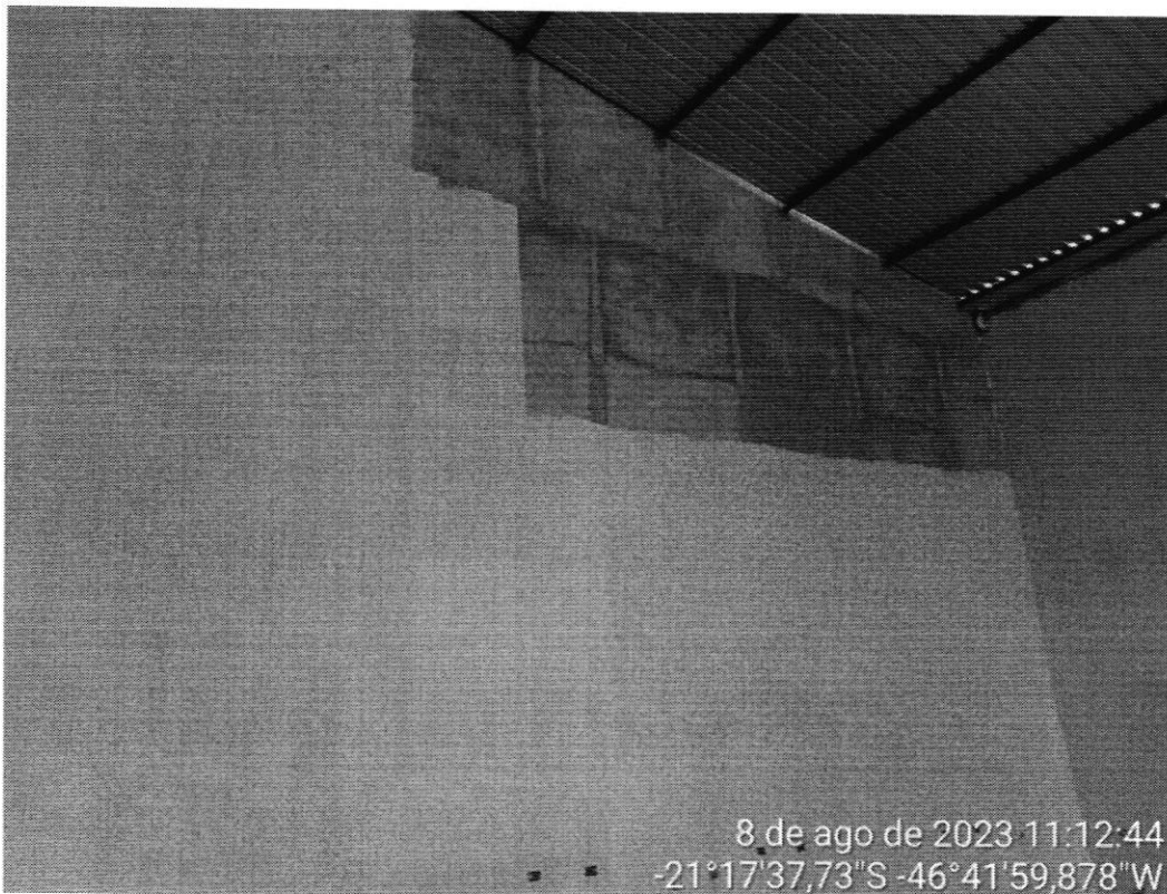
Imagem 5: Fundo selador sendo aplicado no barracão, sem pintura. Caixas de tomada sem espelhos.
