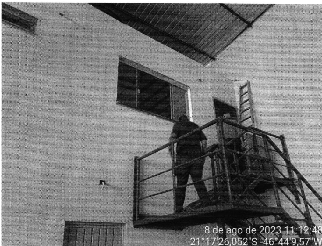
Imagem 6: Escritório somente com fundo selador, caixa de tomada sem espelho, laje de cobertura do escritório sem reboco.
